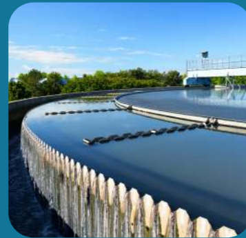
TRATAMIENTO DE AGUA
